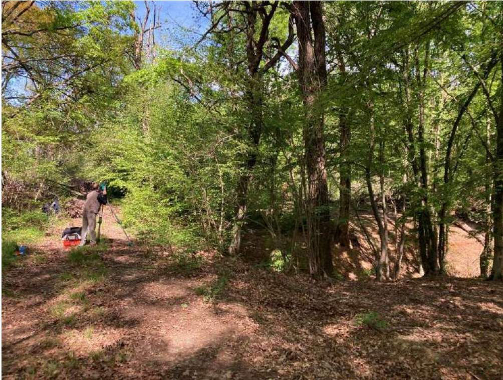
Figura 4-2 – Strada dei Cuminetti oggetto dei dissesti per occlusione dell'attraversamento. (foto: 3634-IMG_8423)
