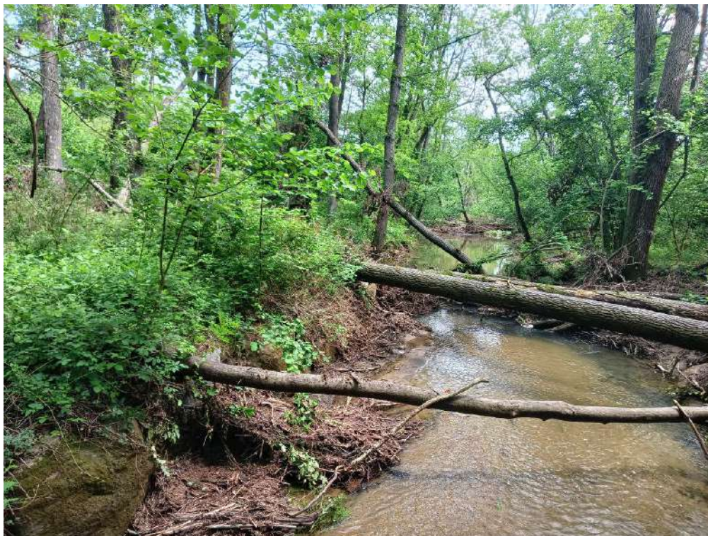
Figura 9-5 – Stato dell'alveo a valle dell'attraversamento. Le piante cadute andranno rimosse per favorire il convogliamento delle portate. (foto: 3658-IMG20230522142224)
