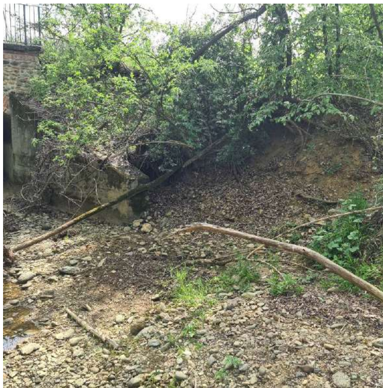
Figura 3-4 – Varice dietro spalla sponda destra di monte del ponte dell'attraversamento. (foto: 3638-20230320_155703)
