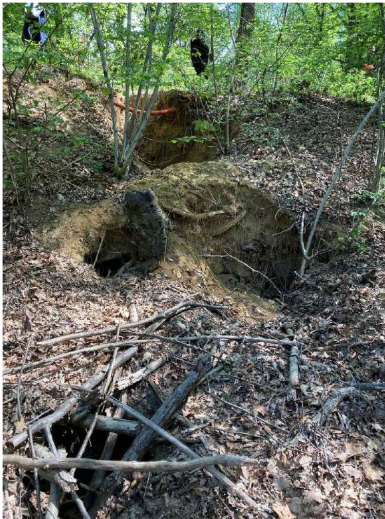
Figura 4-3 – Dissesti del rilevato stradale a monte dell'attraversamento ormai occluso. (foto: 3634-IMG_8429)
