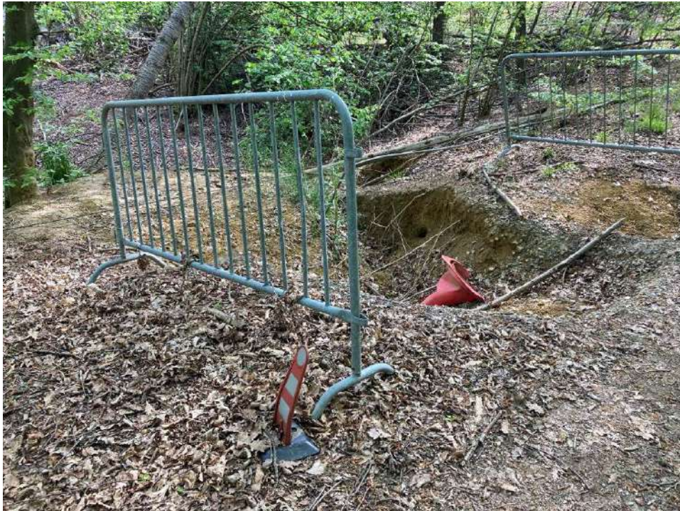
Figura 5-3 – Dissesto nel rilevato di monte dell'attraversamento causato dall'occlusione del condotto. (foto: 3636-IMG_8410)
