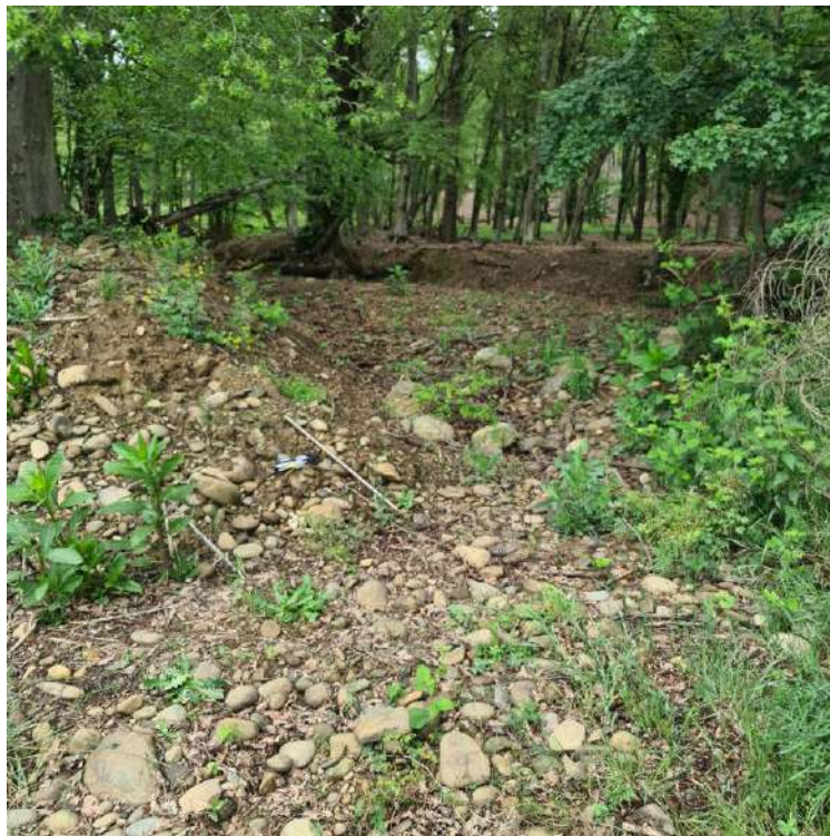
Figura 8-3 – Punto in cui il rio esce dal bosco e guarda la strada in maniera incontrollata. In questo punto si realizza una briglia in legname e pietrame per convogliare correttamente le acque nel successivo guado in massi in progetto. (foto: 3650-20230510_114527)
