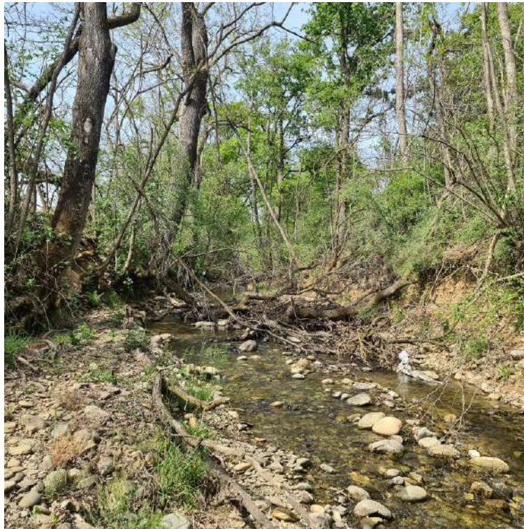
Figura 3-2 – Stato dell'alveo a monte dell'attraversamento. Si notano i detriti vegetali caduti sul fondo, il deposito dei sedimenti al piede della sponda destra (sinistra in foto) e la sponda sinistra (destra in foto) oggetto di erosione. (foto: 3638-20230320_155214)
