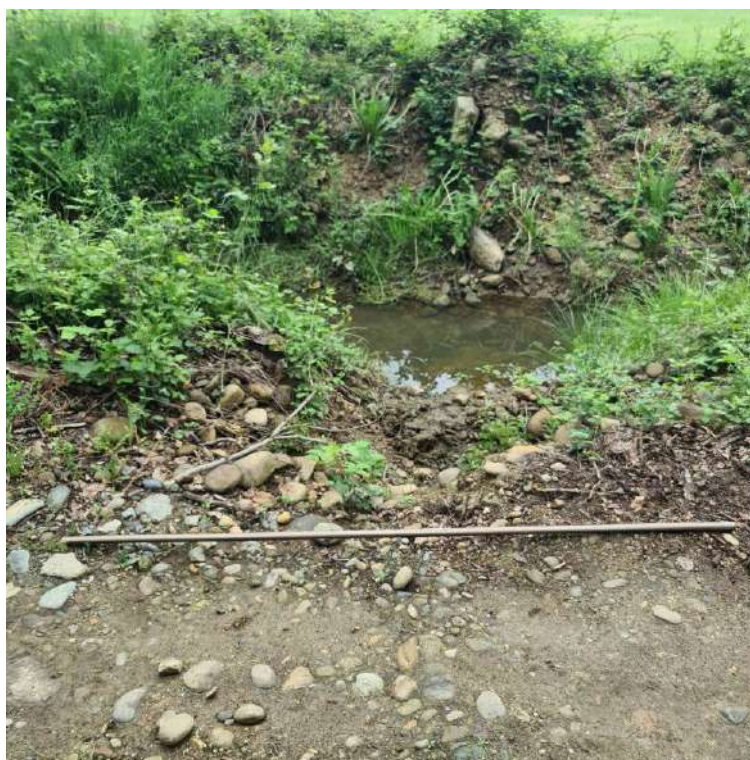
Figura 8-4 – Incisione nella banchina di strada dei Galliassi generata dal ruscellamento dell'acqua sulla carreggiata che si immette successivamente nel fosso adiacente. (foto: 3650-20230510_114518)
