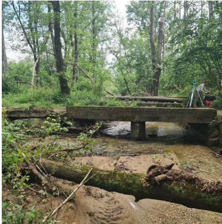
Figura 9-4 – Attraversamento esistente a valle della confluenza del Rio Collesia con un altro rio su Strada dei Galliassi. Le dimensioni dei forni risultano inadeguati al convogliamento delle portate dei corsi d'acqua a piene rive. (foto: 3658-20230522_140948)
