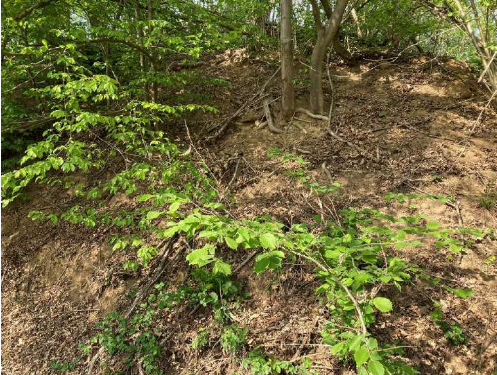
Figura 7-2 – Dissesto diffuso del versante prospiciente Viale dei Roveri. (foto: 3639-IMG_8469)
