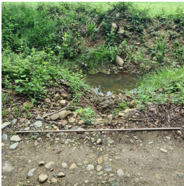
Figura 2-34 – Incisione nella banchina di strada dei Galliassi generata dal ruscellamento dell'acqua sulla carreggiata che si immette successivamente nel fosso adiacente. (foto: 3650-20230510_114518)
