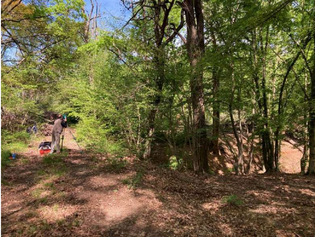
Figura 2-13 – Strada dei Cuminetti oggetto dei dissesti per occlusione dell'attraversamento. (foto: 3634-IMG_8423)
