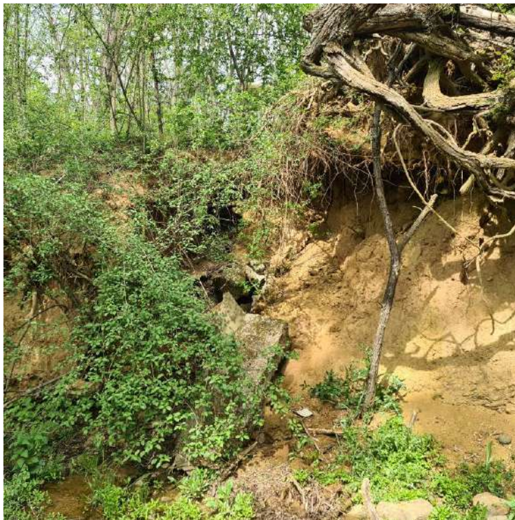
Figura 2-24 – Incisione creatasi nella sponda sinistra in corrispondenza dello scarico della fognatura. (foto: 3637-20230427_151006)
