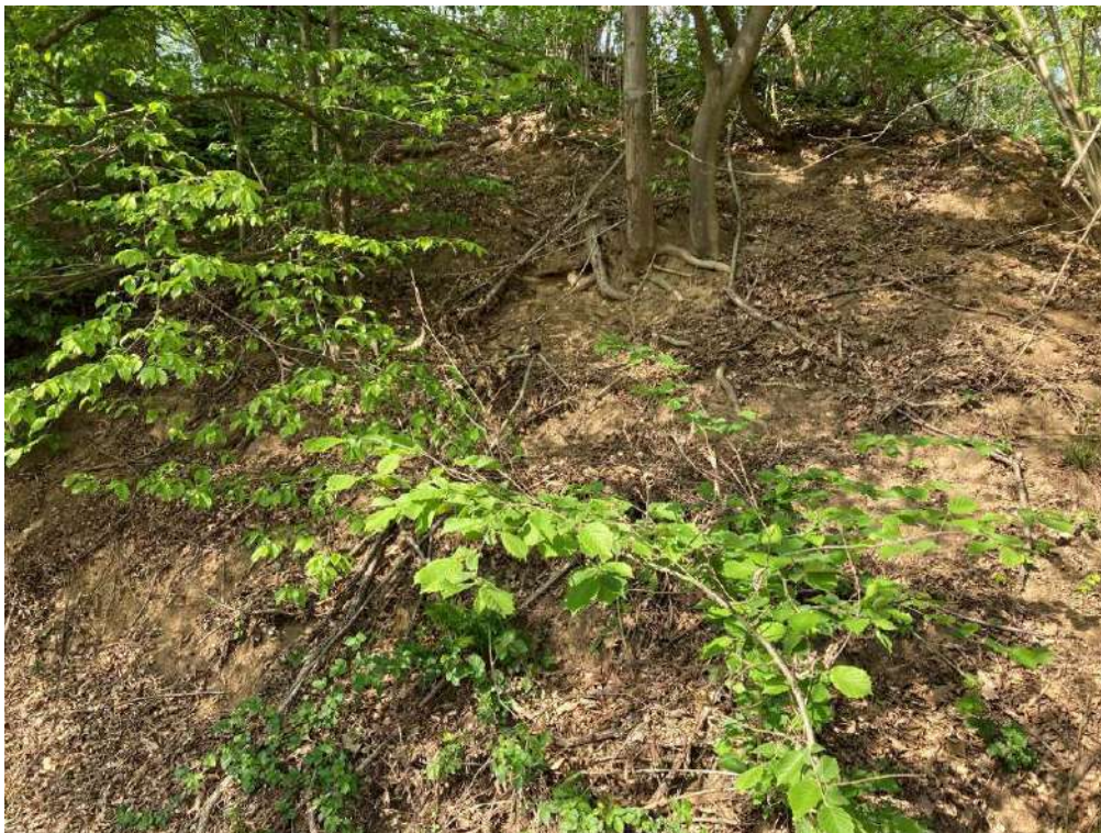
Figura 2-28 – Dissesto diffuso del versante prospiciente Viale dei Roveri. (foto: 3639-IMG_8469)
