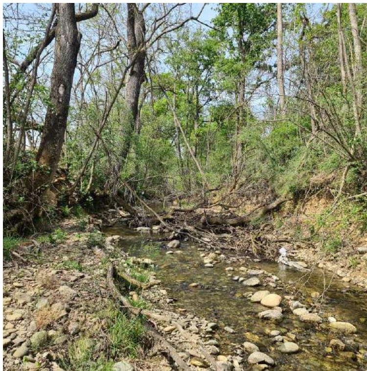
Figura 2-8 – Stato dell'alveo a monte dell'attraversamento. Si notano i detriti vegetali caduti sul fondo, il deposito dei sedimenti al piede della sponda destra (sinistra in foto) e la sponda sinistra (destra in foto) oggetto di erosione. (foto: 3638-20230320_155214)
