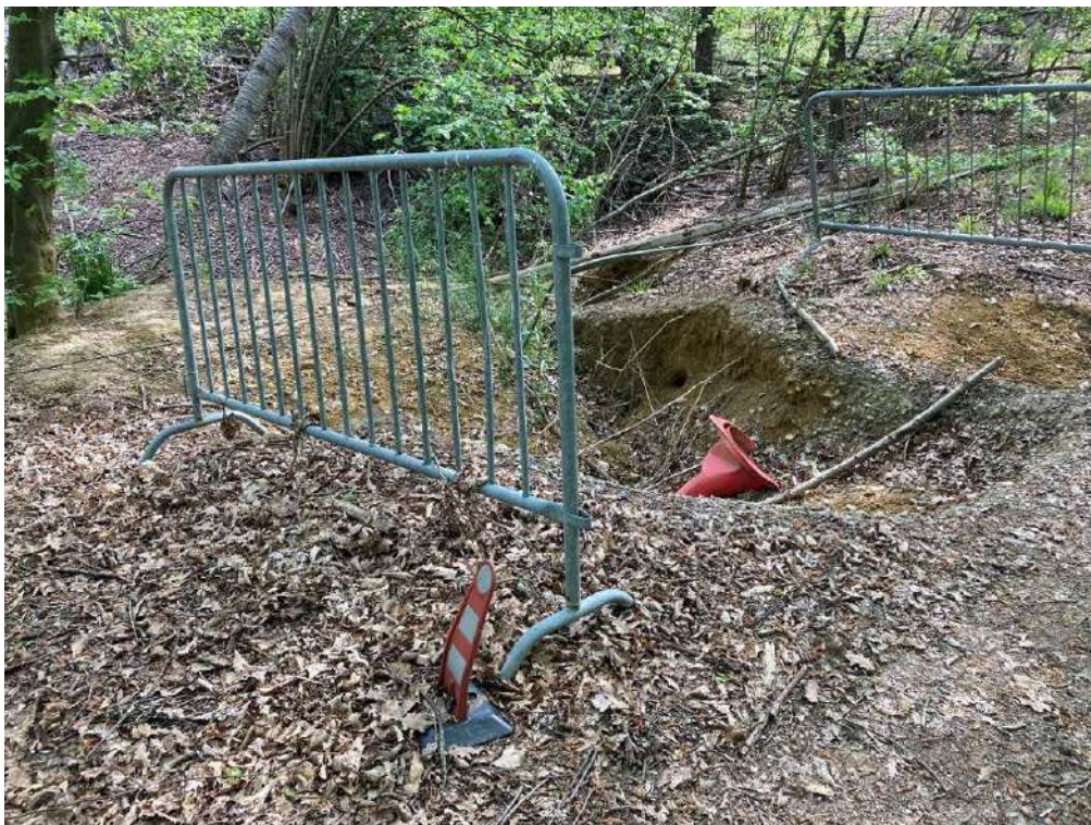
Figura 2-18 – Dissesto nel rilevato di monte dell'attraversamento causato dall'occlusione del condotto. (foto: 3636-IMG_8410)
