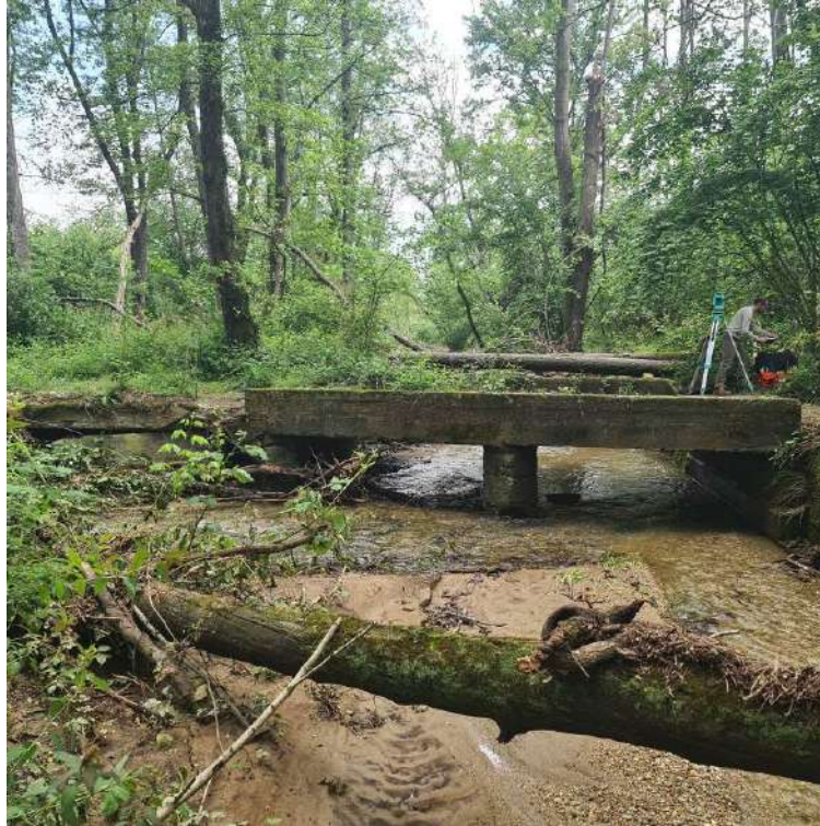
Figura 2-37 – Attraversamento esistente a valle della confluenza del Rio Collesia con un altro rio su Strada dei Galliassi. Le dimensioni dei forni risultano inadeguati al convogliamento delle portate dei corsi d'acqua a piene rive. (foto: 3658-20230522_140948)
