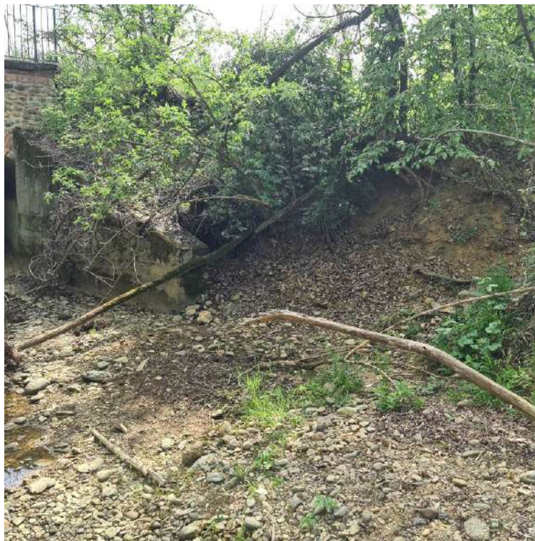
Figura 2-10 – Varice dietro spalla sponda destra di monte del ponte dell'attraversamento. (foto: 3638-20230320_155703)
