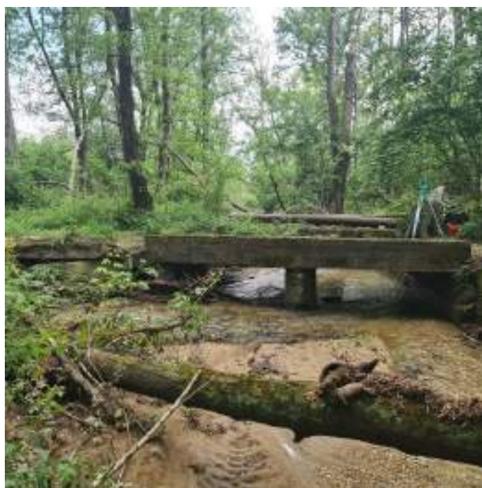
Figura 33 – Attraversamento esistente a valle della confluenza del Rio Collesia con un altro rio su Strada dei Galliassi. Le dimensioni dei fornici risultano inadeguati al convogliamento delle portate dei corsi d'acqua a piene rive. (foto: 3658-20230522_140948)
