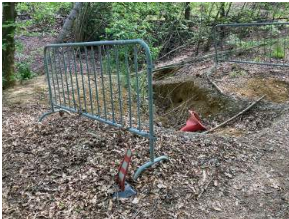
Figura 14 – Dissesto nel rilevato di monte dell'attraversamento causato dall'occlusione del condotto. (foto: 3636-IMG_8410)
