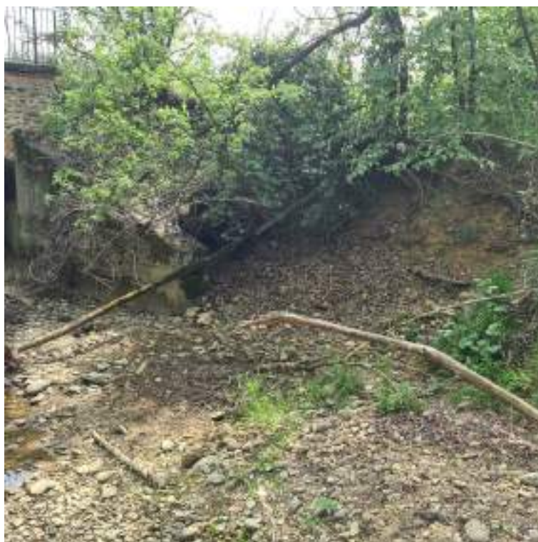
Figura 6 – Varice dietro spalla sponda destra di monte del ponte dell'attraversamento. (foto: 3638-20230320_155703)
