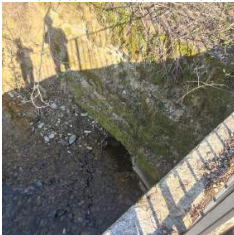
Figura 5 – Varice al piede della spalla sinistra di monte dell'attraversamento. (foto: 3638-20230320_152343)
