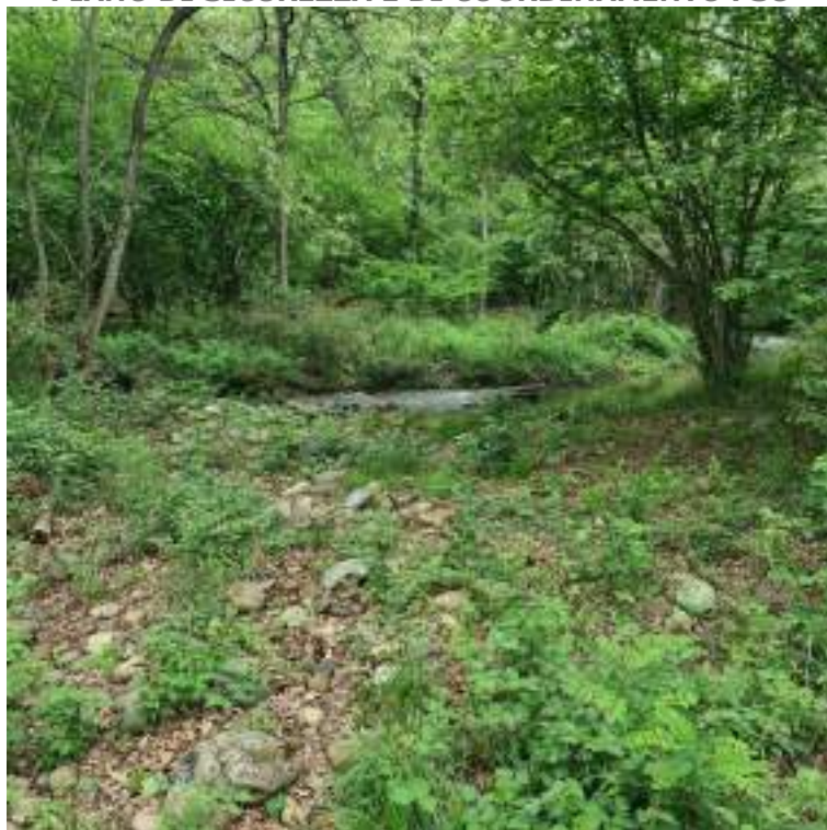
Figura 31 – Punto in cui la sponda sinistra del rio Collesia, abbassandosi, consente all'acqua in piena di straripare e generare problemi alla strada dei Galliassi. (foto: 3650-20230510_134414)
