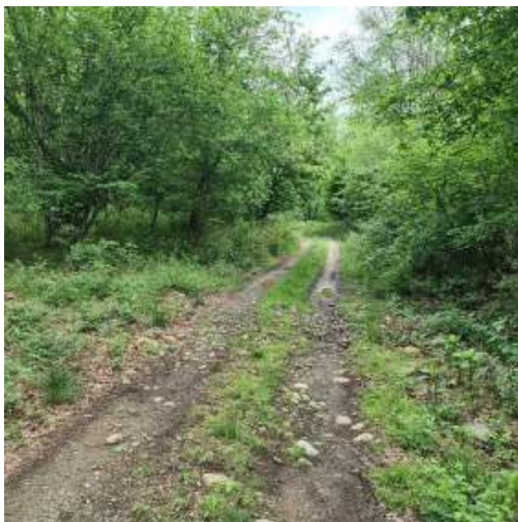
Figura 32 – Punto di strada dei Galliassi in cui l'acqua non più trattenuta dall'alveo attraversa la carreggiata stradale guadandola. (foto: 3650-20230510_134437)
