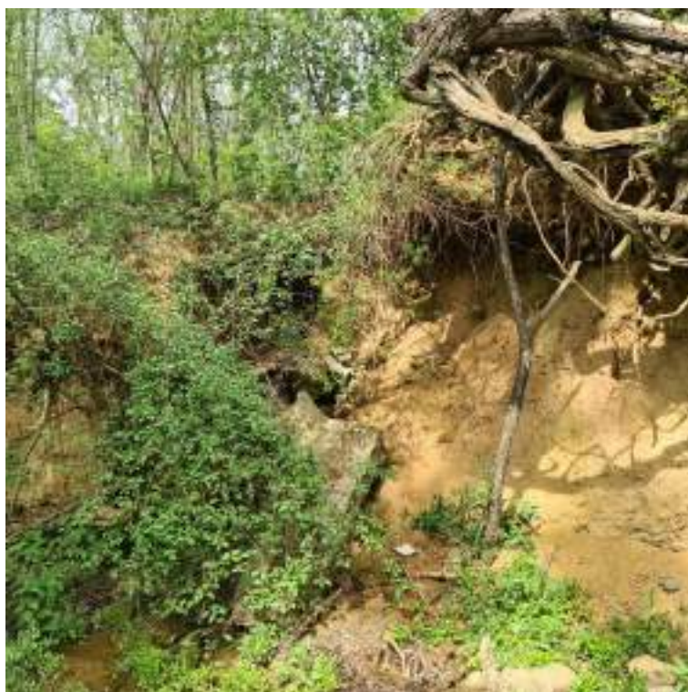
Figura 20 – Incisione creatasi nella sponda sinistra in corrispondenza dello scarico della fognatura. (foto: 3637-20230427_151006)
