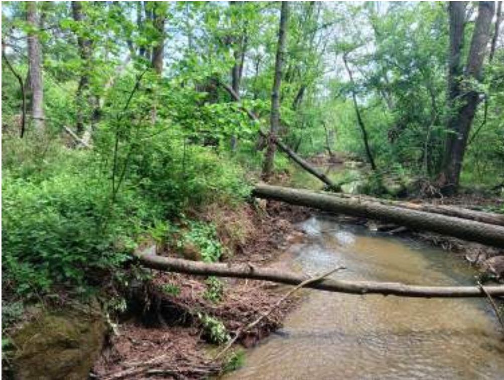
Figura 34 – Stato dell'alveo a valle dell'attraversamento. Le piante cadute andranno rimosse per favorire il convogliamento delle portate. (foto: 3658-IMG20230522142224)
