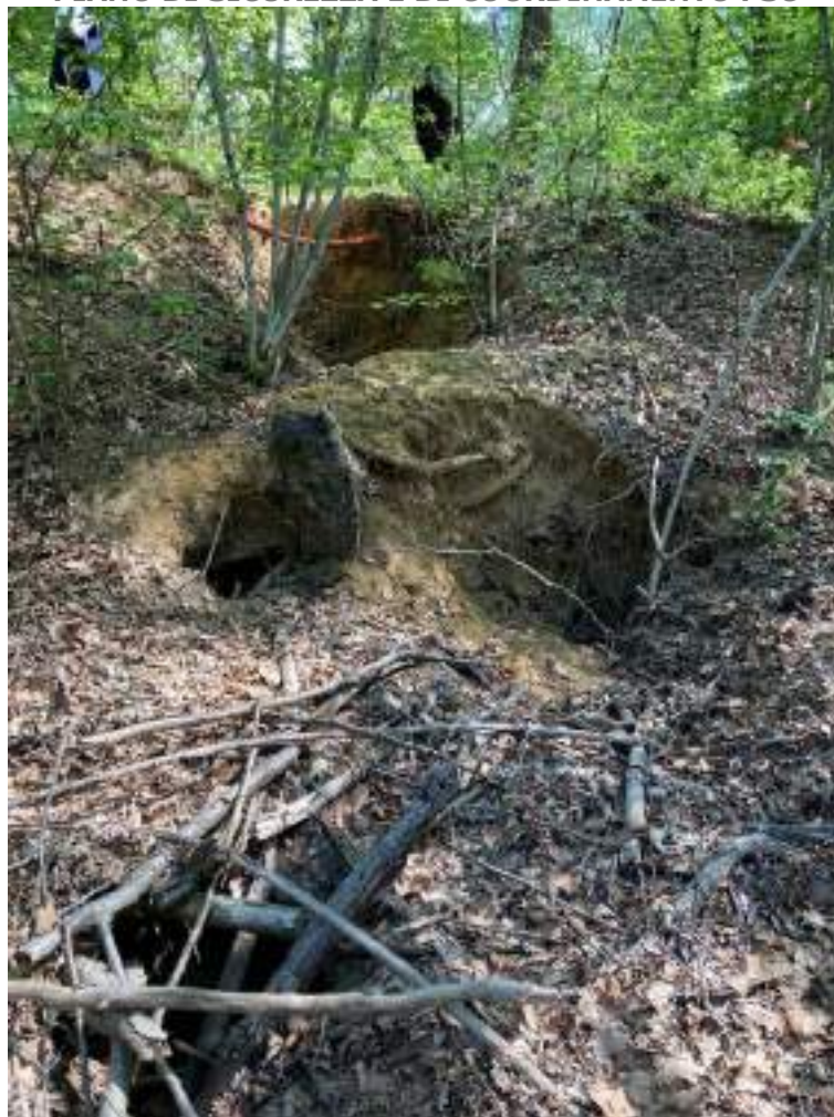
Figura 10 – Dissesti del rilevato stradale a monte dell'attraversamento ormai occluso. (foto: 3634-IMG_8429)
