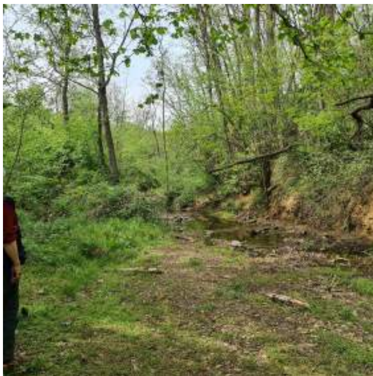
Figura 18 – Stato dell'alveo a monte dell'intervento: si vede la barra di materiali sedimentari sulla sinistra e la vegetazione caduta sulla destra. (foto: 3637-20230427_150939)
