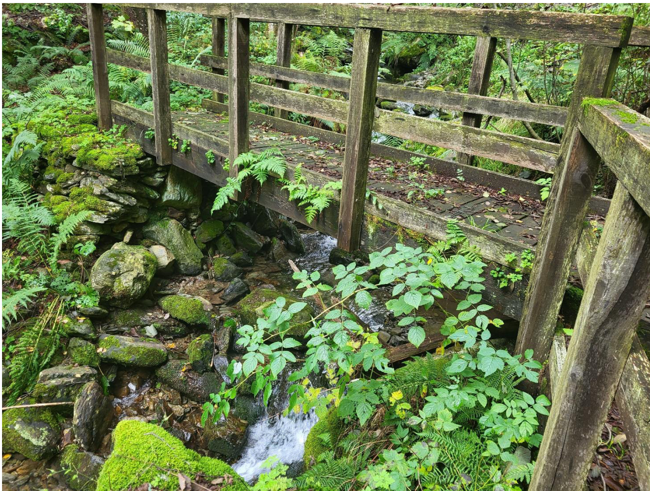
Figura 4 - Particolare della spalla (con muratura disarticolata) in dx del ponticello per attraversamento t. Arzola
