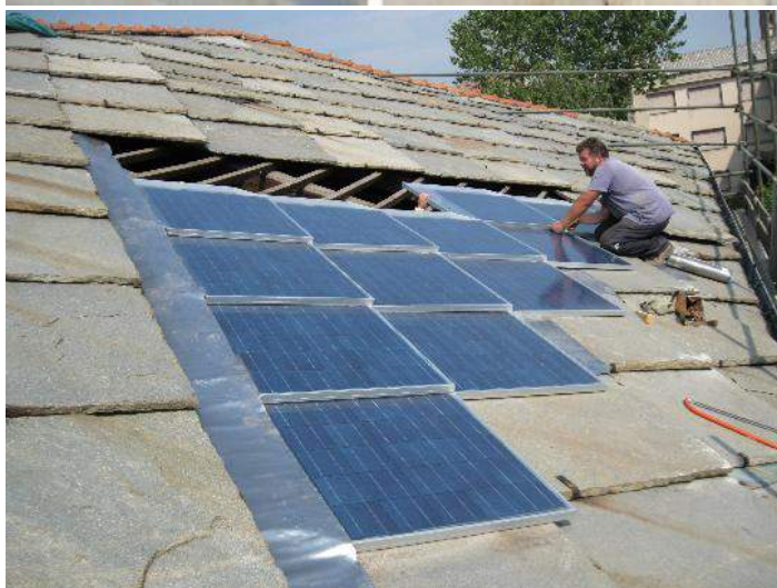
Esempio di copertura in losa integrata da pannelli fotovoltaici: impianto delle Scuole Elementari, Comune di Luserna S. Giovanni
