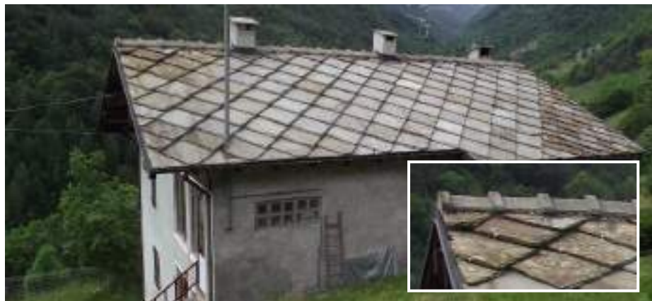
Realizzazione del colmo con coppone in cemento – Soluzione sconsigliata
