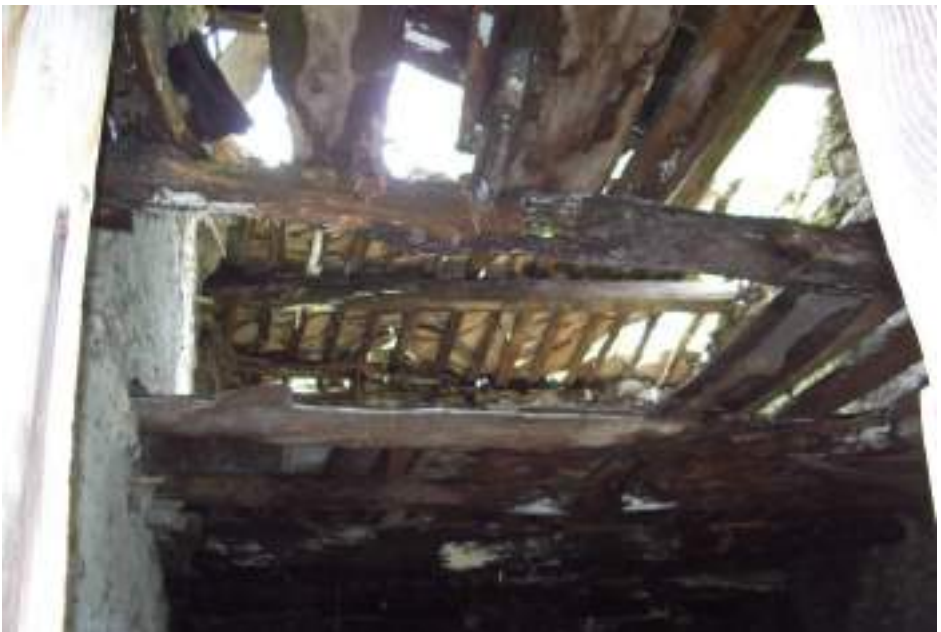
Solaio in legno, quasi totalmente crollato, Borgata Porence
