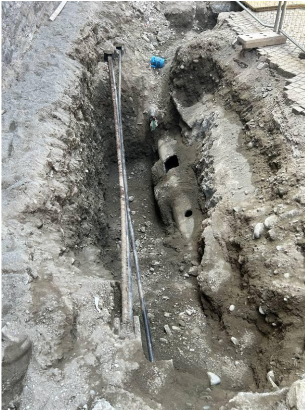
La presenza del condotto fognario
