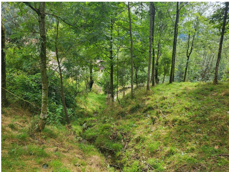
Foto 6 – Impluvio da sistemare per evitare esondazioni verso le abitazioni di fraz. Riva a valle
