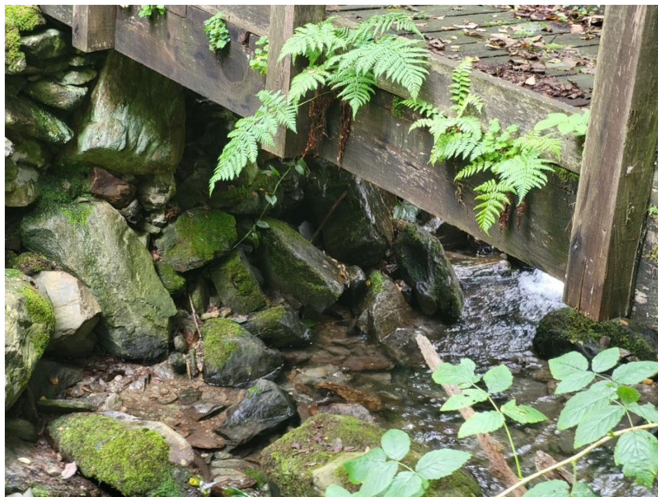
Foto 4 - Dettaglio del franamento della spalla in destra
