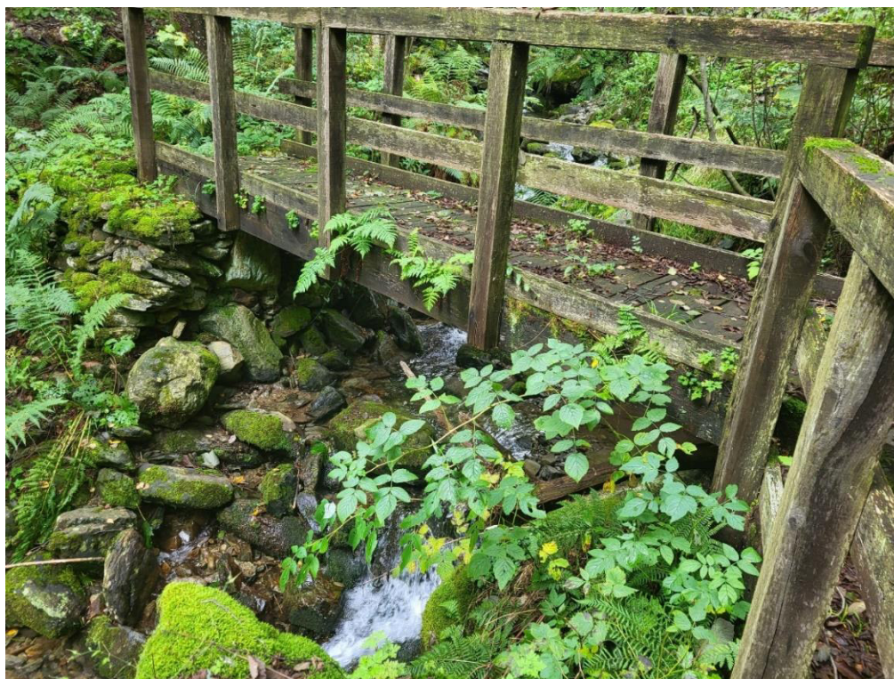
Foto 3 - Particolare della spalla (con muratura disarticolata) in dx del ponticello per attraversamento t. Arzola
