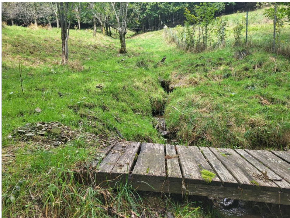
Foto 5 – Passerella di attraversamento di un impluvio secondario aggirata dalle acque a causa dell'occlusione della luce
