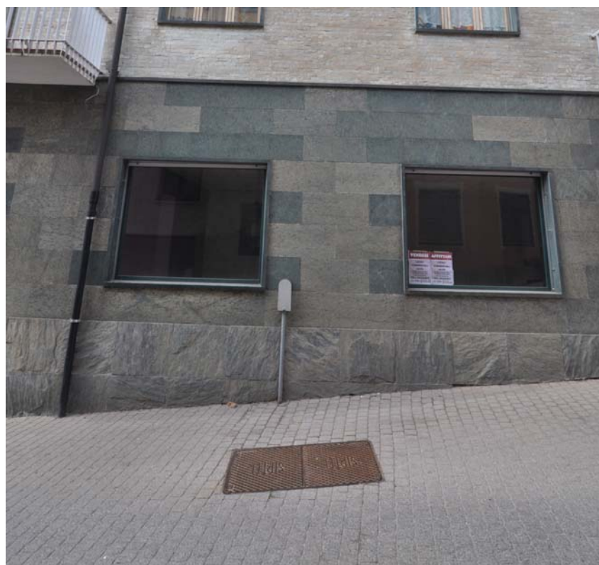
RIVESTIMENTO IMPROPRIO DI FACCIATA
