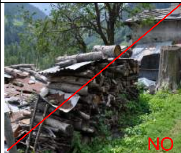
Fig.3- Coperture arrugginite e mal posizionate
