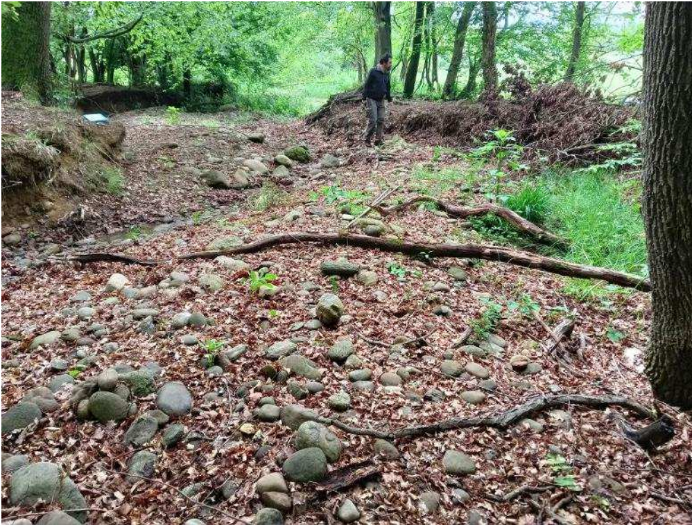
Figura 2-28 – Stato dell'alveo del rio laterale che attraversa strada dei Galliassi: si osservano le erosioni sia in sponda destra e successivamente in sinistra, causate dall'azione dell'acqua durante le ondate di piena. (foto: 3650-IMG20230510121736)
