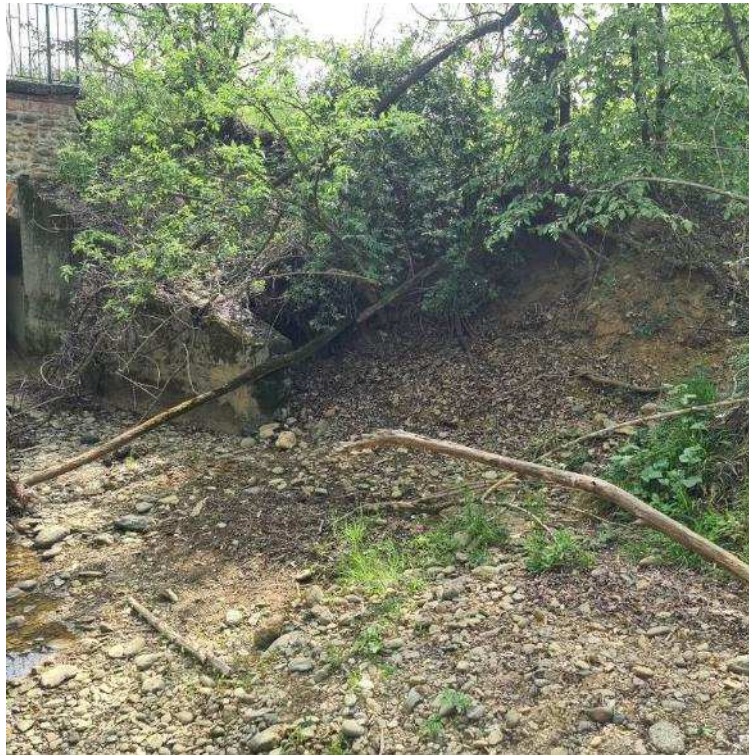
Figura 2-6 – Varice dietro spalla sponda destra di monte del ponte dell'attraversamento. (foto: 3638-20230320_155703)
