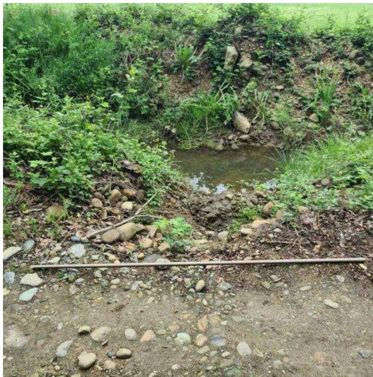
Figura 2-30 – Incisione nella banchina di strada dei Galliassi generata dal ruscellamento dell'acqua sulla carreggiata che si immette successivamente nel fosso adiacente. (foto: 3650-20230510_114518)
