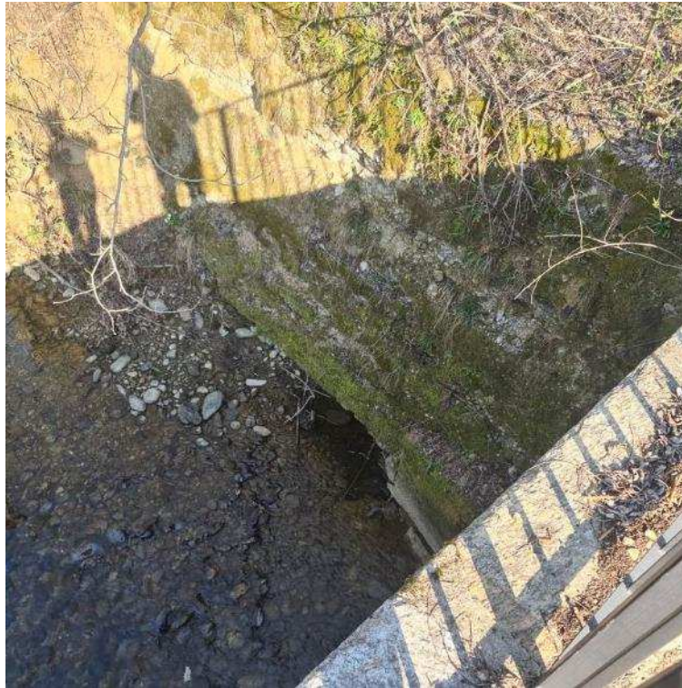
Figura 2-5 – Varice al piede della spalla sinistra di monte dell'attraversamento. (foto: 3638-20230320_152343)
