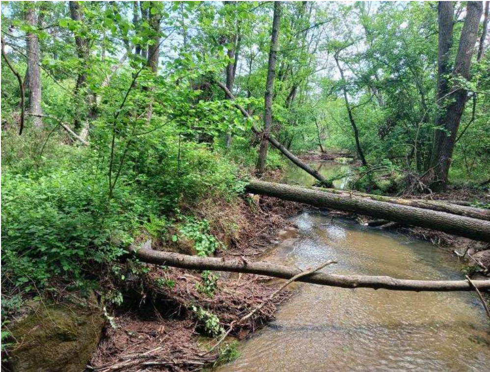
Figura 2-34 – Stato dell'alveo a valle dell'attraversamento. Le piante cadute andranno rimosse per favorire il convogliamento delle portate. (foto: 3658-IMG20230522142224)
