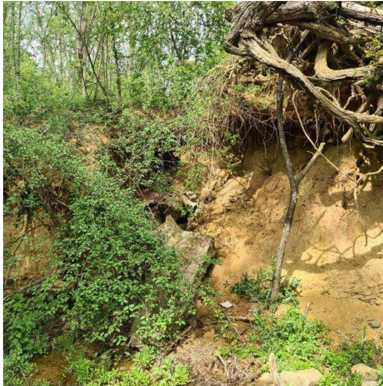
Figura 2-20 – Incisione creatasi nella sponda sinistra in corrispondenza dello scarico della fognatura. (foto: 3637-20230427_151006)
