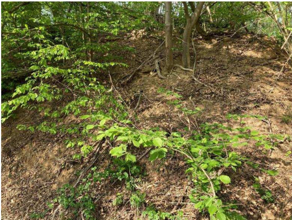
Figura 2-24 – Dissesto diffuso del versante prospiciente Viale dei Roveri. (foto: 3639-IMG_8469)
