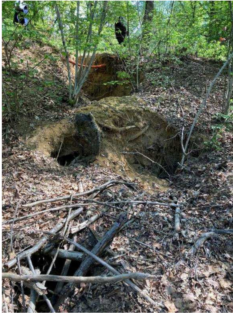
Figura 2-10 – Dissesti del rilevato stradale a monte dell'attraversamento ormai occluso. (foto: 3634-IMG_8429)
