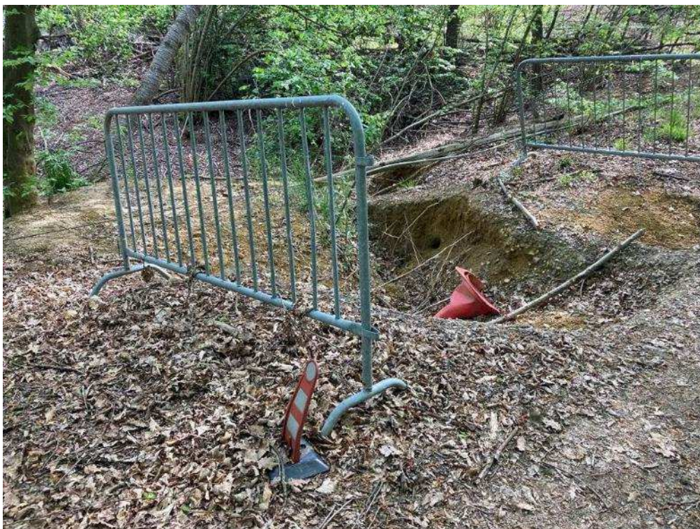
Figura 2-14 – Dissesto nel rilevato di monte dell'attraversamento causato dall'occlusione del condotto. (foto: 3636-IMG_8410)
