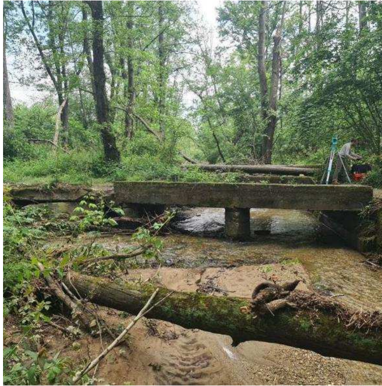
Figura 2-33 – Attraversamento esistente a valle della confluenza del Rio Collesia con un altro rio su Strada dei Galliassi. Le dimensioni dei fornici risultano inadeguati al convogliamento delle portate dei corsi d'acqua a piene rive. (foto: 3658-20230522_140948)
